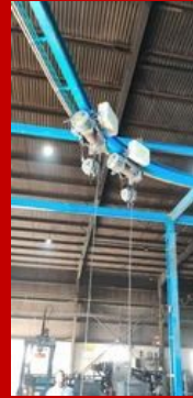
3 Ton Monorail System
